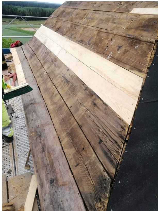
Det fanns en del rötskador på lanterninentaket vilka lagats i med nya brädor.
