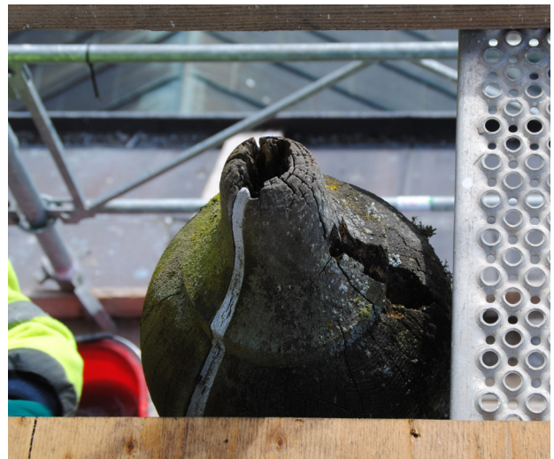
De svarvade hörnstolparna i ek hade stora rötskador och samtliga hade hål i toppen.
