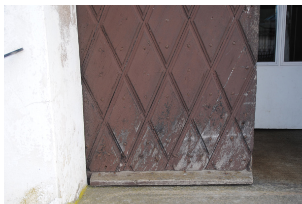
Färgskiktet på huvudentréns pardörrar flagnade. Nedtill där dörren fått mest stryk av väder och vind var färgskiktet mycket skadat. Själva dörren var dock i gott skick.
