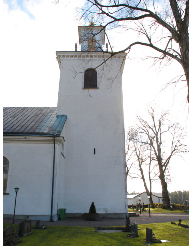
Tornets norra och östra sidor hade mindre påväxt av alger, men färgskiktet var vittrat.
