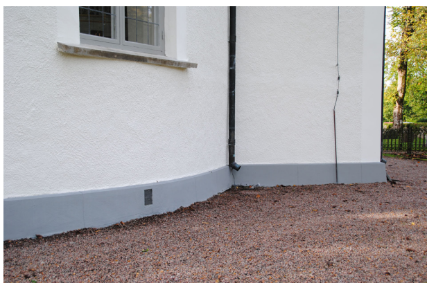
Kyrkans sockel efter putslagning, rengöring och ommålning med grå silikatfärg.
