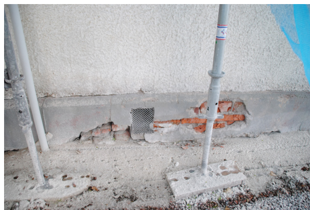
Putsskada på kyrkans sockel. Överlag var putsen annars i gott skick.
