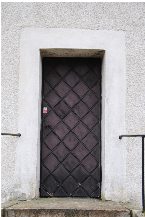
Sakristians dörr i öster före ommålning. Färgskiktet flagnade och kulören var blekt och förändrad.
