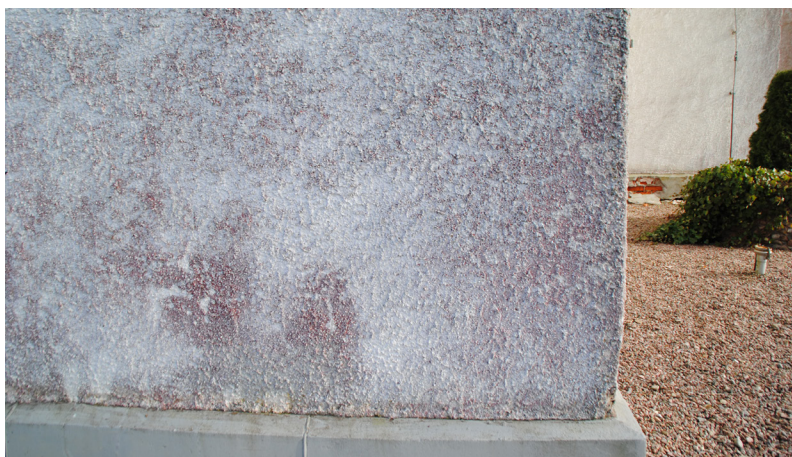
Kyrkan var målad med kalkcementfärg. Rödalger förekommer ofta i stor omfattning på väggar avfärgade med KC-färg. Särskilt de södra och västra fasaderna brukar var utsatta.
