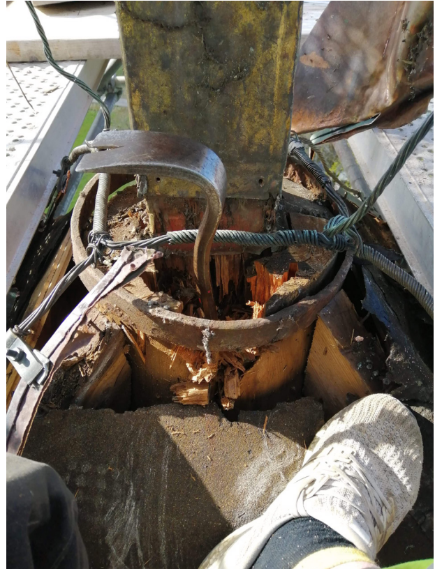
Efter inspektion av tornkorset stomme och infästning konstaterades stora rötskador.
