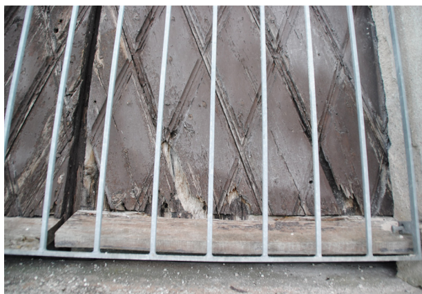
Nederkanten på tornluckorna hade en hel del rötskador på panelen. Särskilt tornluckorna åt väster och söder var skadade.
