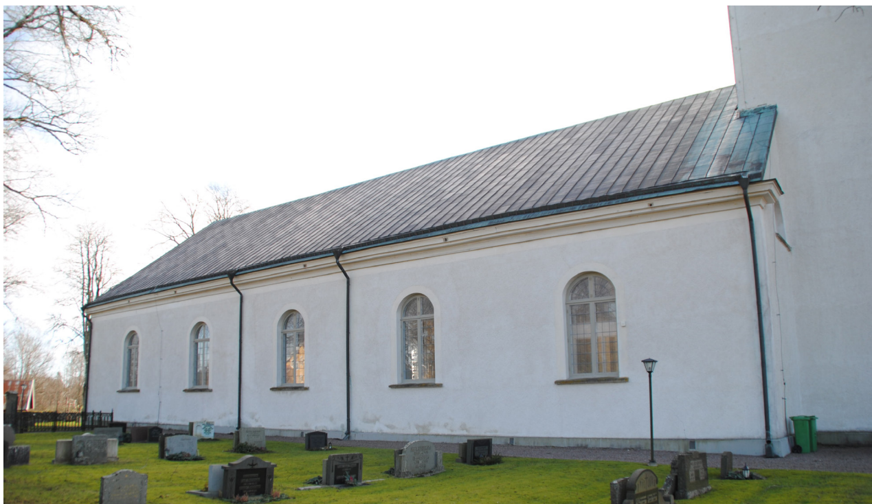
Norra långhusväggen. Det fanns en del missfärgningar och påväxter på fasaden, särskilt nära sockeln.
