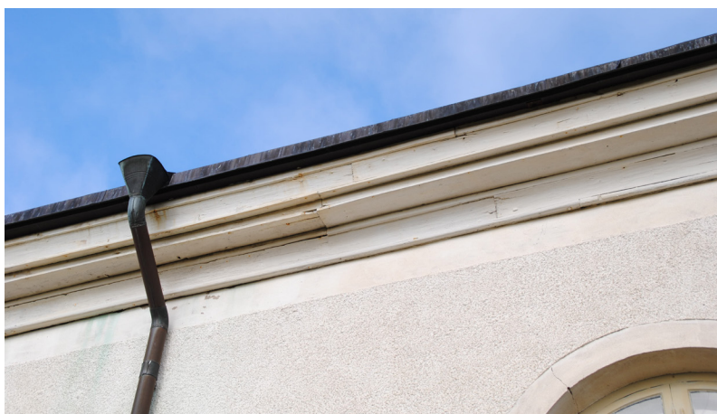
Underslaget på långhustaket är tillverkat av trä och målat i ungefär samma kulör som fasaden. Färgen på underslaget flagnade och spikar hade rostat och gett genomslag i färgskiktet.
