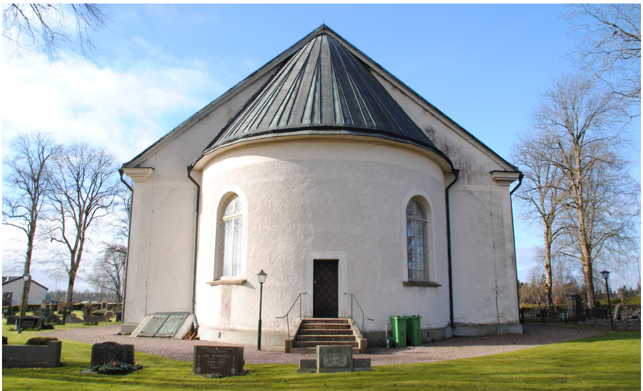
Koret och långhusets östra gavel. Norr om sakristian var långhusväggen kraftigt missfärgad av smuts och påväxt.
